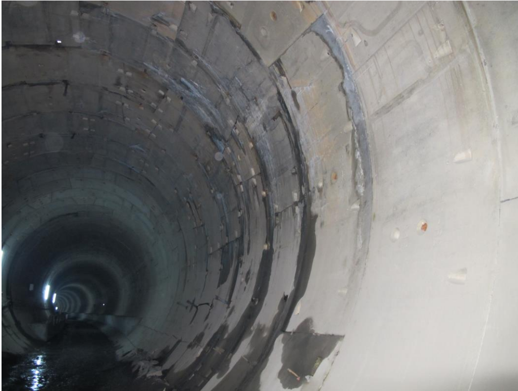
Şekil 6.1 : Segment aralarında meydana gelen su kaçakları.
