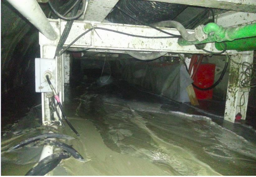
Şekil 5.1 : Baküde açılmakta olan bir atıksu tüneline meydana gelen sıvılaşma/kum akması olayı.
