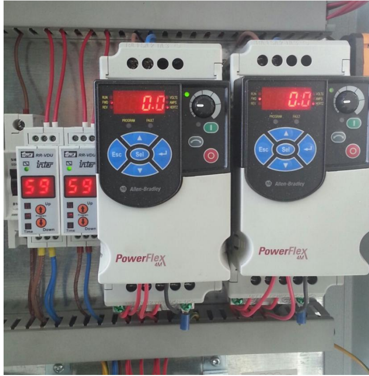
Şekil 3.20 : Mekanik titreşim sisteminin elektrik panosu.
