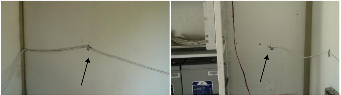
Şekil 4.15 : Sağ ve sol iç yüzey.
