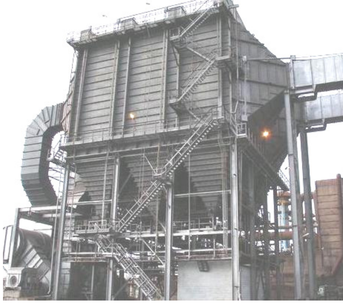
Şekil 2.7 : Elektrostatik filtre altındaki toplama hazneleri.
