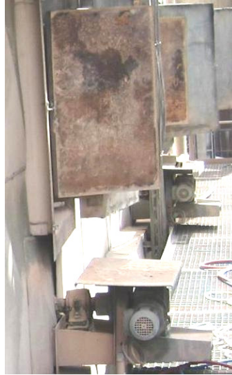
Şekil 2.21 : Toplama elektrotu çekişleme tahrik motorları.
