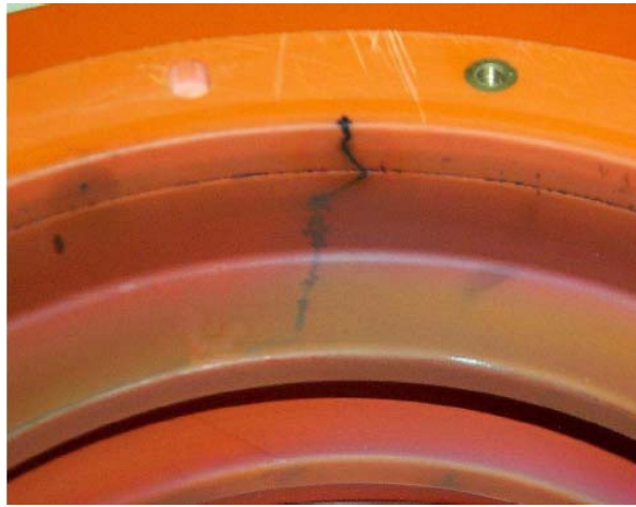
Şekil 2.4: Geçit İzolatörü Yüzeyinde Oluşan Kirlenme Atlaması
