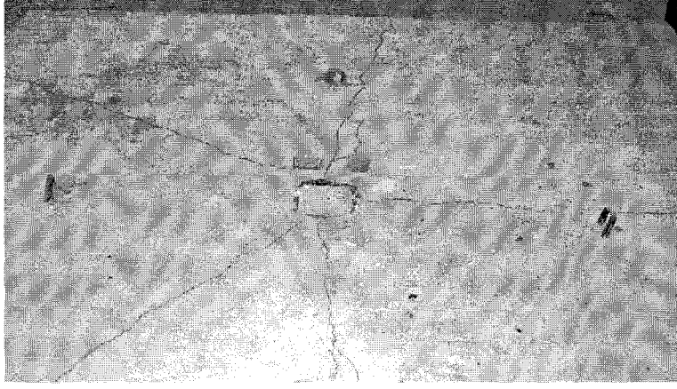
Şekil 5.7 P1 Plağı Üst Yüzeyi, Çatlak Yayılış Biçimi
