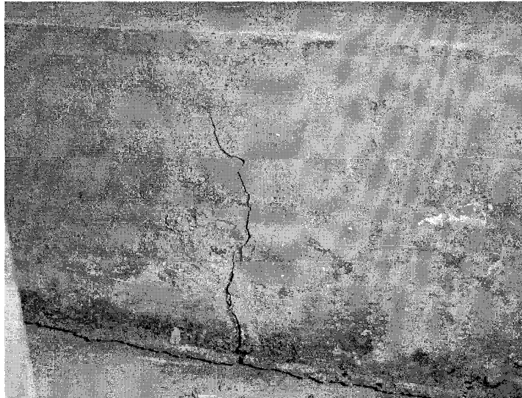
Şekil 5.13 P2 Plağı 3A Çatlağı
