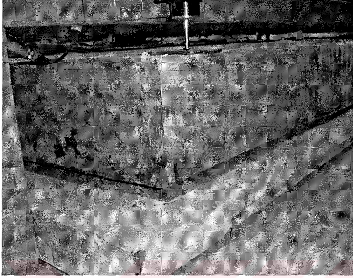
řekil 5.11 P2 Plađının Köşe Noktasının Kalkması
