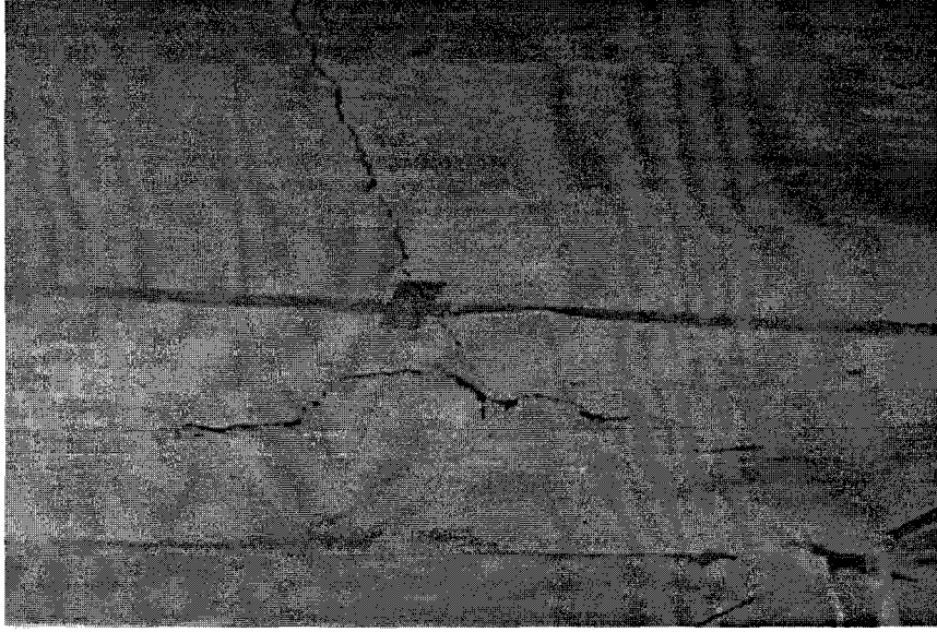
Şekil 5.22 P3 Plağının Orta Noktasının Altıtan Görünümü
