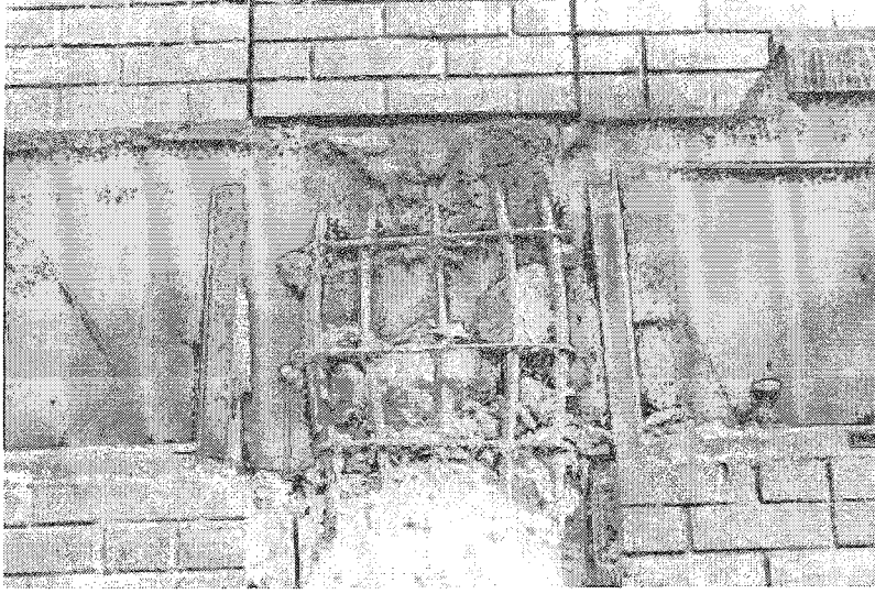
Şekil 1.3 Kısa kolon durumu. 1985 Şili Depremi [1]
