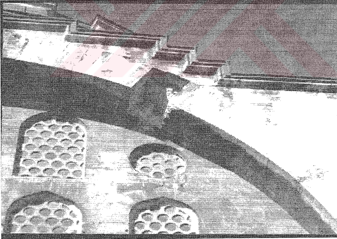
Şekil 8.4.b Kible cephesindeki kemer taşının düştüğü yer
