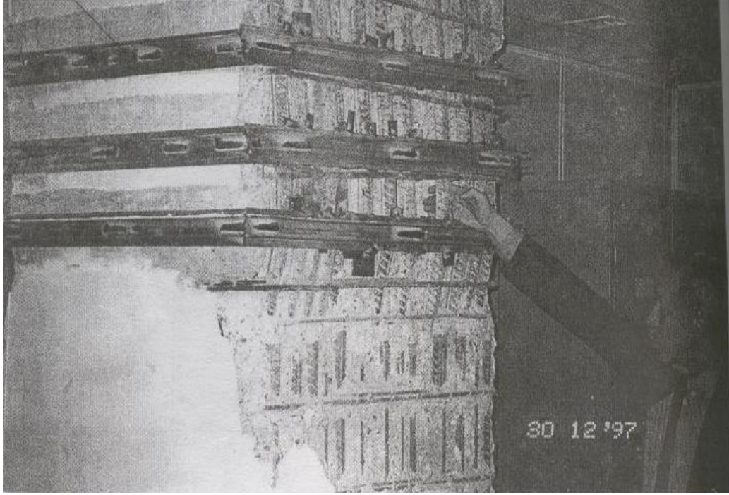
Şekil 9.6 Hasar Gören Kolon
