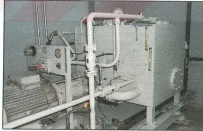
Şekil 4.11. Hidrolik Ünitenin Genel Görünüşü (Elektrik Motoru, Pompa ve Yağ Tankı)
