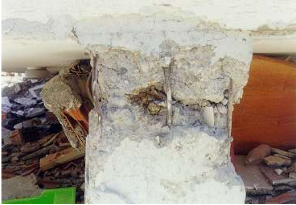
Şekil 3.67. Kolon ucunda betonda toprak parçası ve iri çakıllar
