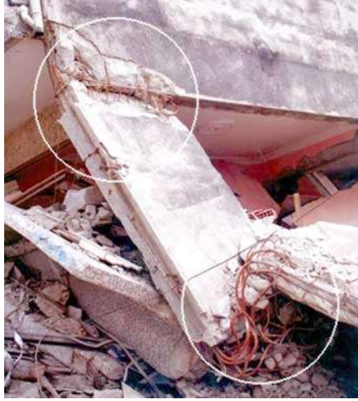
Şekil 3.60. Döğüm noktalarında ağır hasar gören perde
