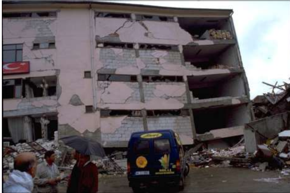
Şekil 3.36. Pencere boşluğu sonucu oluşan kısa kolon
