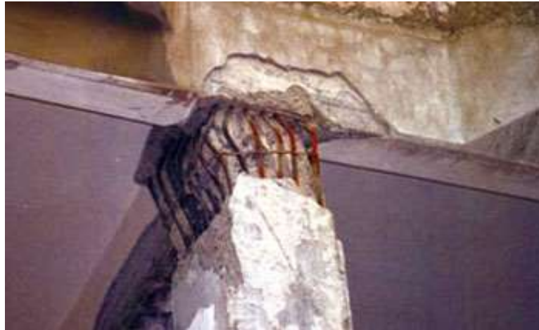
Şekil 3.46. Etriye yetersizliği sonucu hasar gören kolon
