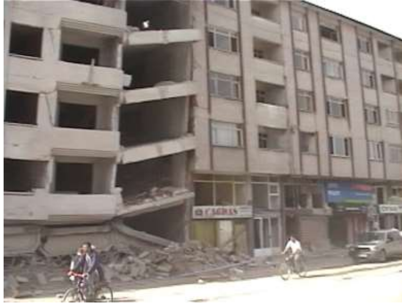
Şekil 3.71. Çarpışma sonucu binada oluşan hasar
