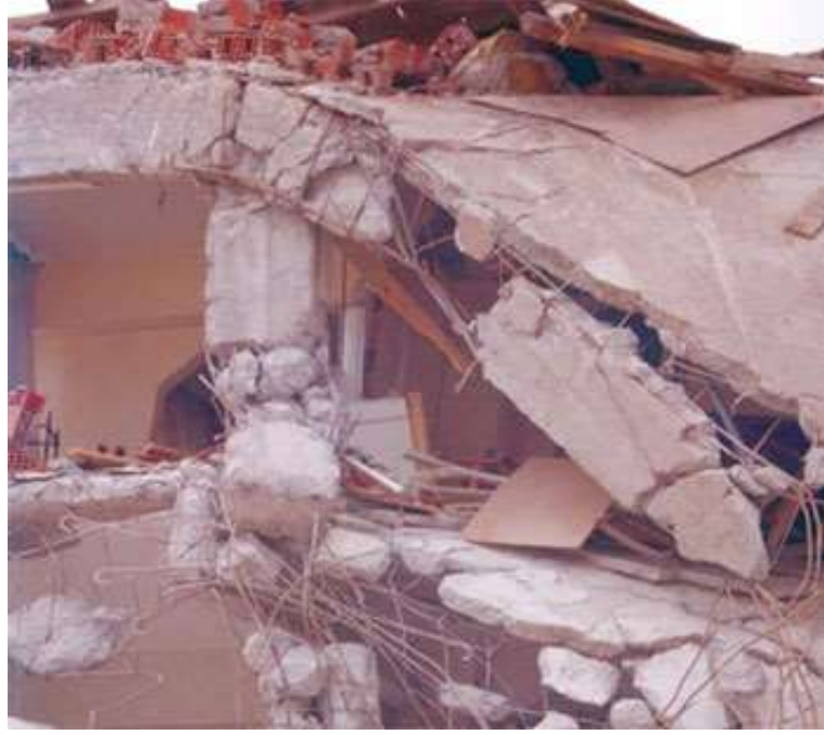
Şekil 3. 66. Kalitesiz beton sonucu ağır hasar
