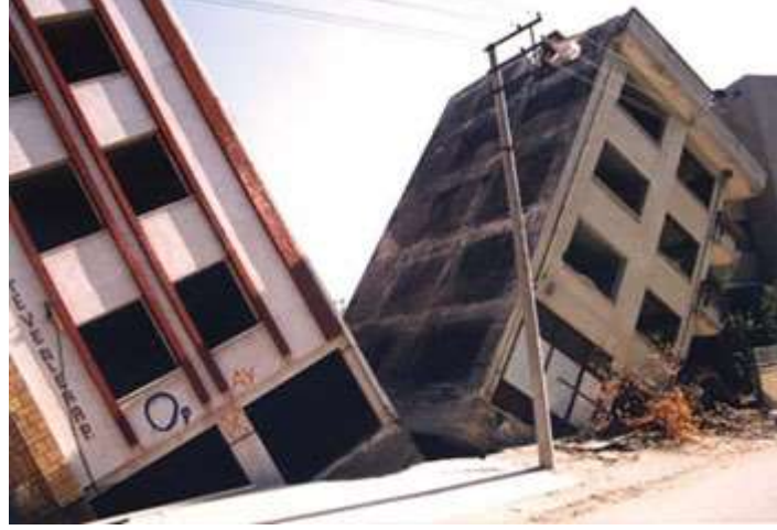
Şekil 3.79. Sıvılaşma sonucu devrilen iki bina
