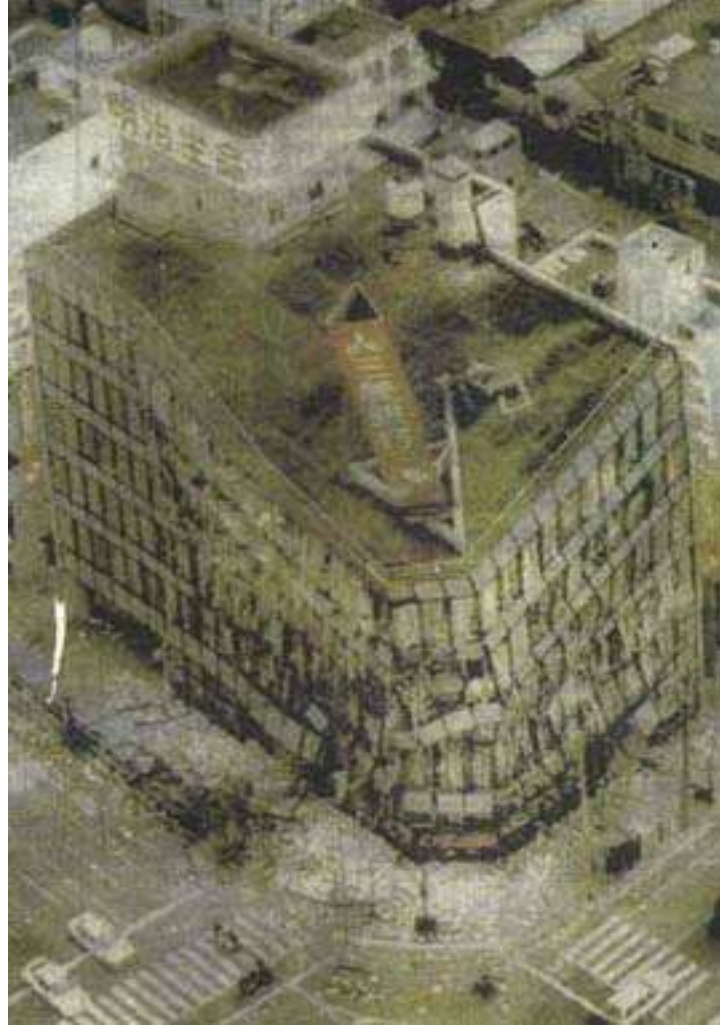
Şekil 3.2 Burulma düzensizliği sonucu ağır hasar görmüş bina
