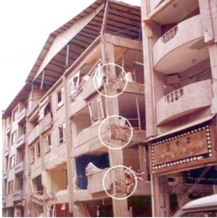
Şekil 3.91. Korozyon sonucu ağır hasar
