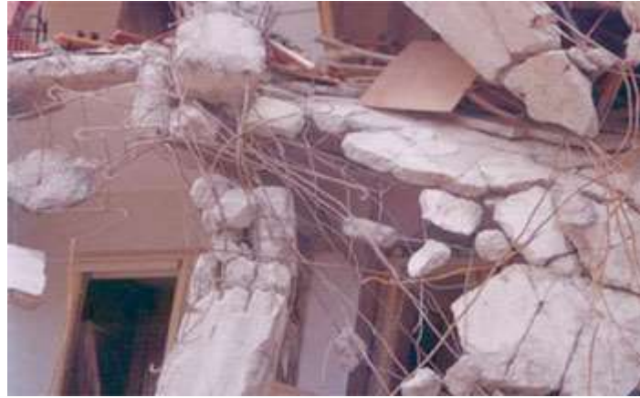
Şekil 3.65. Kalitesiz beton uygulaması
