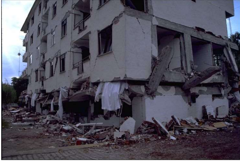
Şekil 3.28. Ara katın göçmesi durumu
