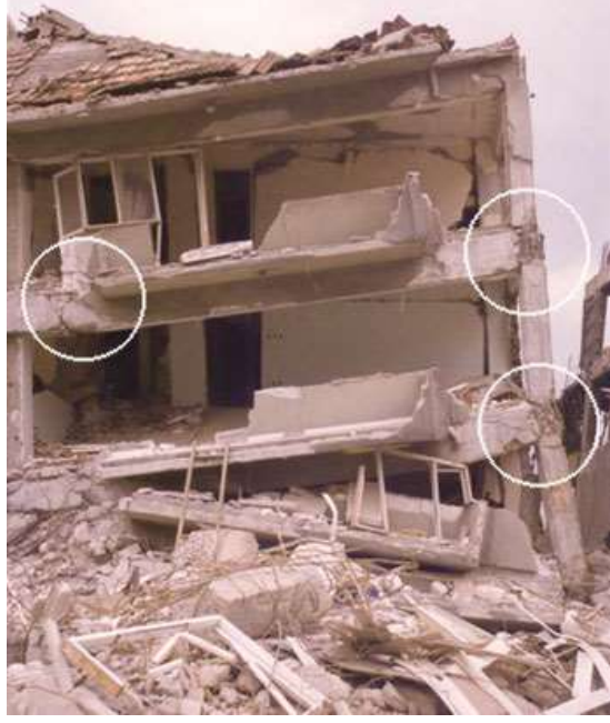
Şekil 3.92. Geniş kiriş açıklığı sonucu ağır hasarlı bina
