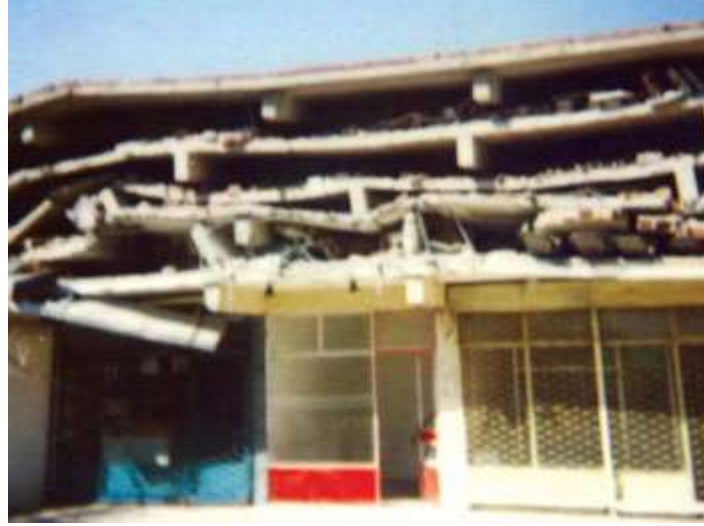
Şekil 3.63. Zayıf kolon- güçlü kiriş sonucu ağır hasarlı bina
