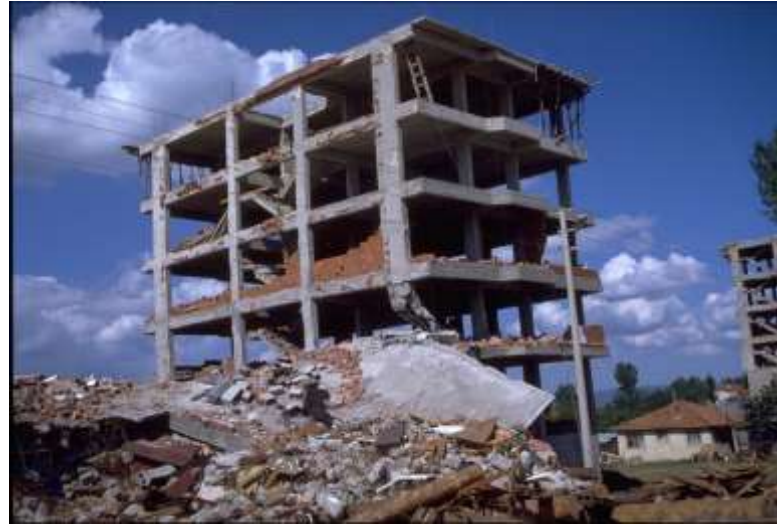
Şekil 3.73. Çöken binanın çekiçleme sonucu yan binanın kolonuna verdiği zarar
