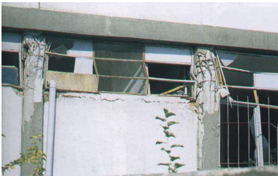
Şekil 3.34. Bant pencere nedeniyle kısa kolon hasarı - Düzce Lisesi
