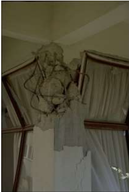
Şekil 3.41. Kolon hasarı- İzmit
