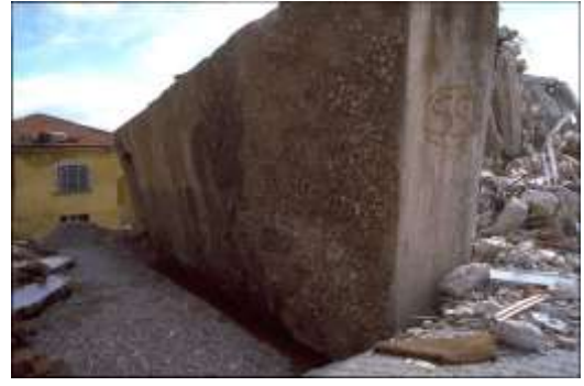
Şekil 3.76. Sıvılaşma sonucu temel durumu
