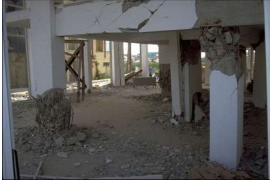
Şekil 3.44. Kolonda kesme hasarı sonucu ağır hasarlı bina
