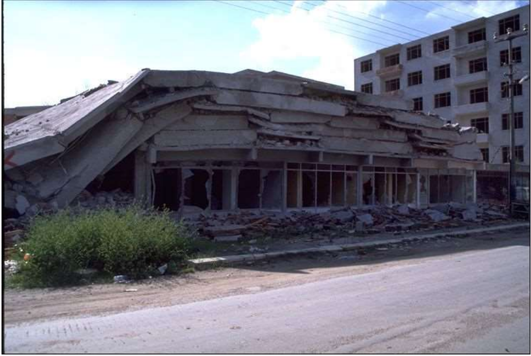
Şekil 3.64. Zayıf kolon - güçlü kiriş hasarı
