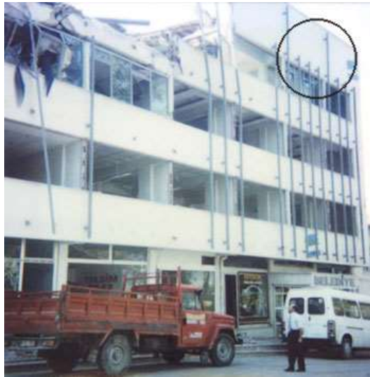
Şekil 3.93. Ağır kütle hasarı
