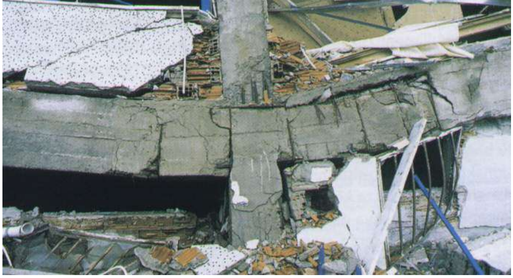
Şekil 3.43. Kolon - kiriş birleşim bölgesi hasarı
