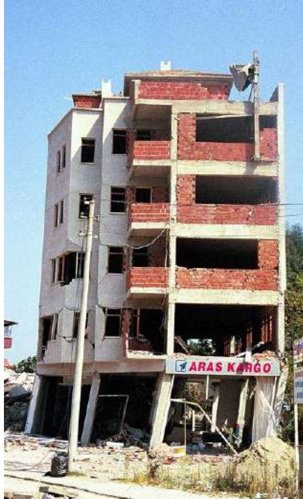
Şekil 3.23. Yumuşak kat sorunu - İzmit
