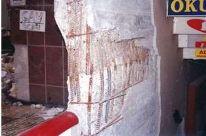
řekil 3.51. Enine donatı yetersizliđi sonucu oluřan hasar
