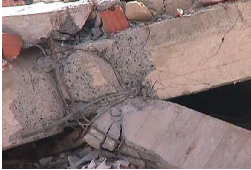
Şekil 3.40. Ağır hasarlı binada kolon-kiriş birleşim bölgesinde hasar
