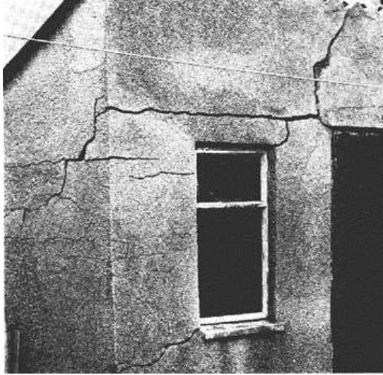
Şekil 3.11 Duvar kaplamalarında çatlak oluşumu [10]
