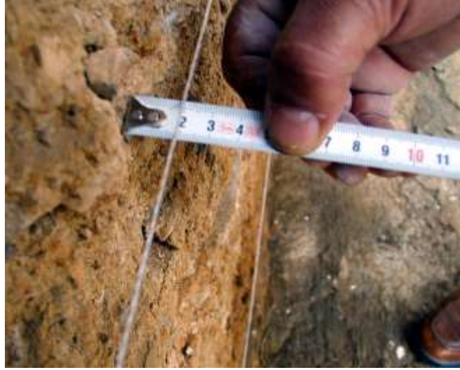
Şekil 4.13 Açılı kerpiç yapı duvarında aşınma
