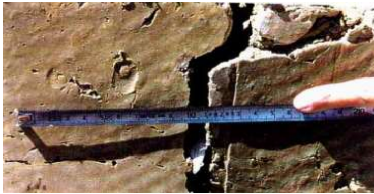
Şekil 4.11 Likit kıvamındaki karışımın oluşturduğu rötre çatlağı (23)
