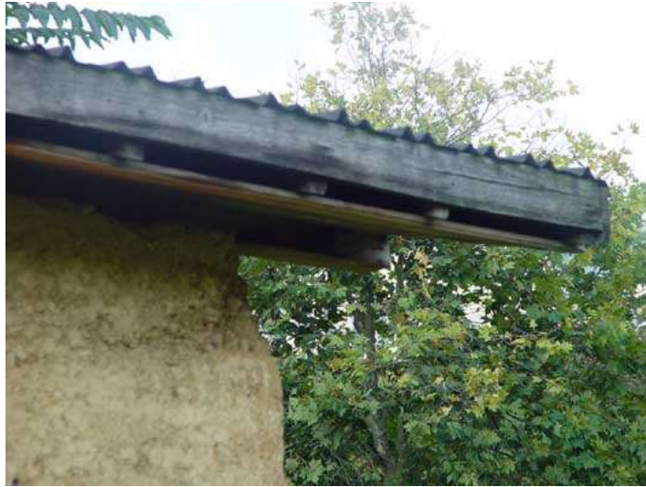
Şekil 4.21 Duvarlarda köşelerin yeterli sıkıştırıl maması ndan kaynaklanan hasarlar
