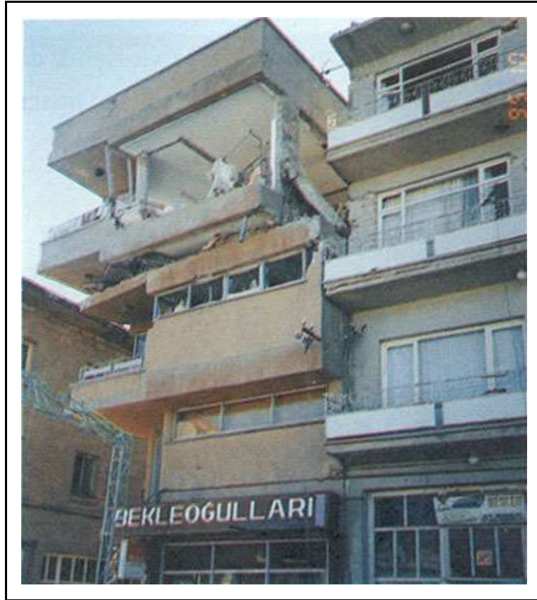
Şekil 4.14. Dinar'da çekişme etkisi ile ara katlarından biri yıkılan bina
