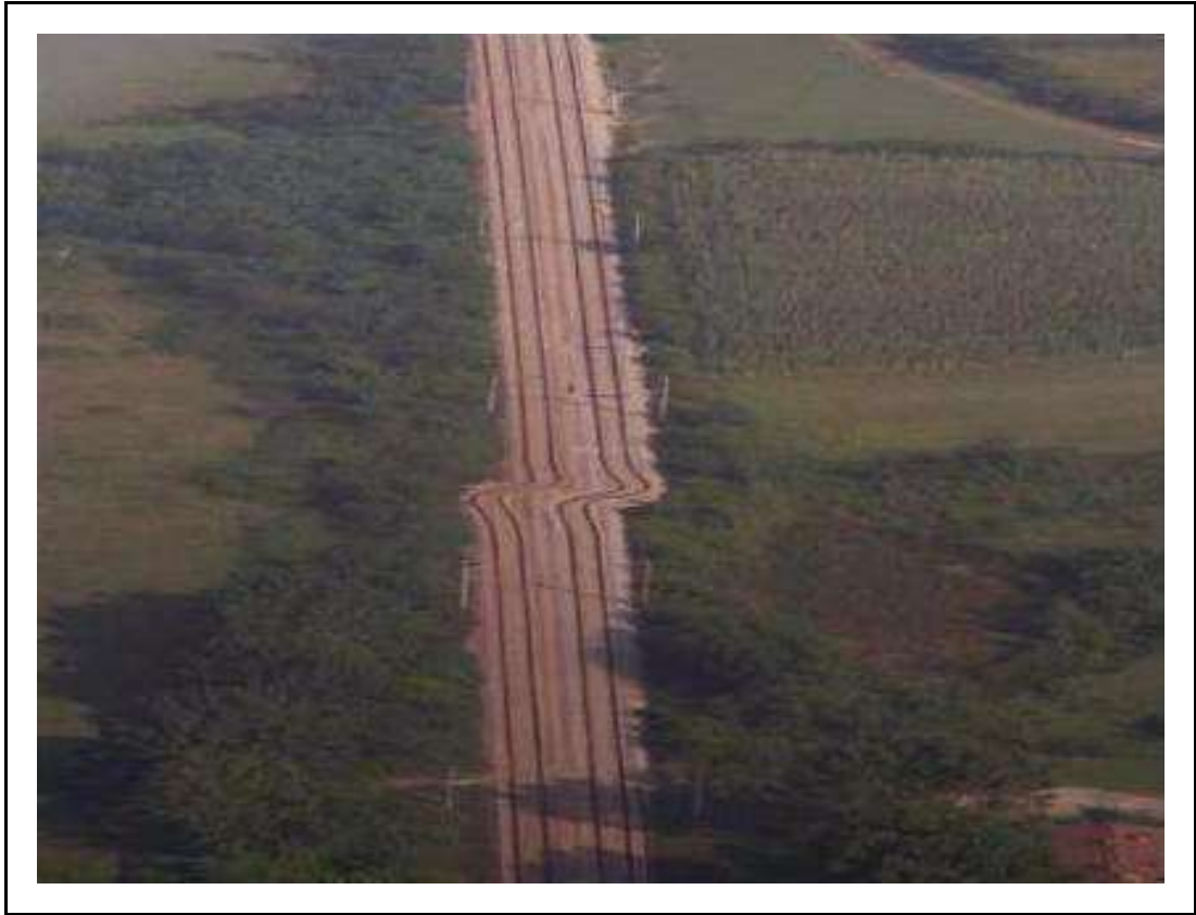
Şekil 5.3 17 Ağustos depreminde oluşan yüzey kırığının demiryoluyla kesiştiği noktada neden olduğu deformasyon
