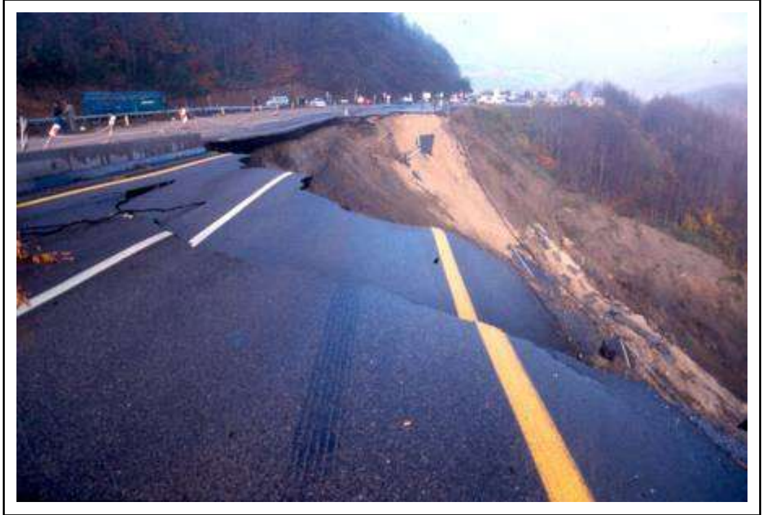
Şekil 2.5. 12 Kasım 1999 Düzce depreminde E-5 karaydunun Bdu Dağı geçişinde meydana gelen toprak kayması
