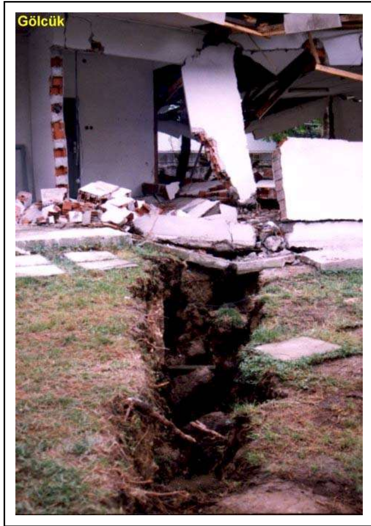
Şekil 2.1 Gölcük'te yüzey kırığı üzerinde yer alan bir bina
