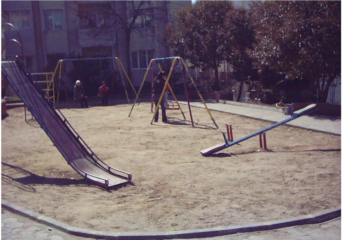
Şekil C.16: Uygulama hatalı yerleşim, geleneksel bozuk oyun elemanları. (Bağlarbaşı İç Parkı, Çocuk Oyun Alanı, Selami Ali-Üsküdar, 2003.)
