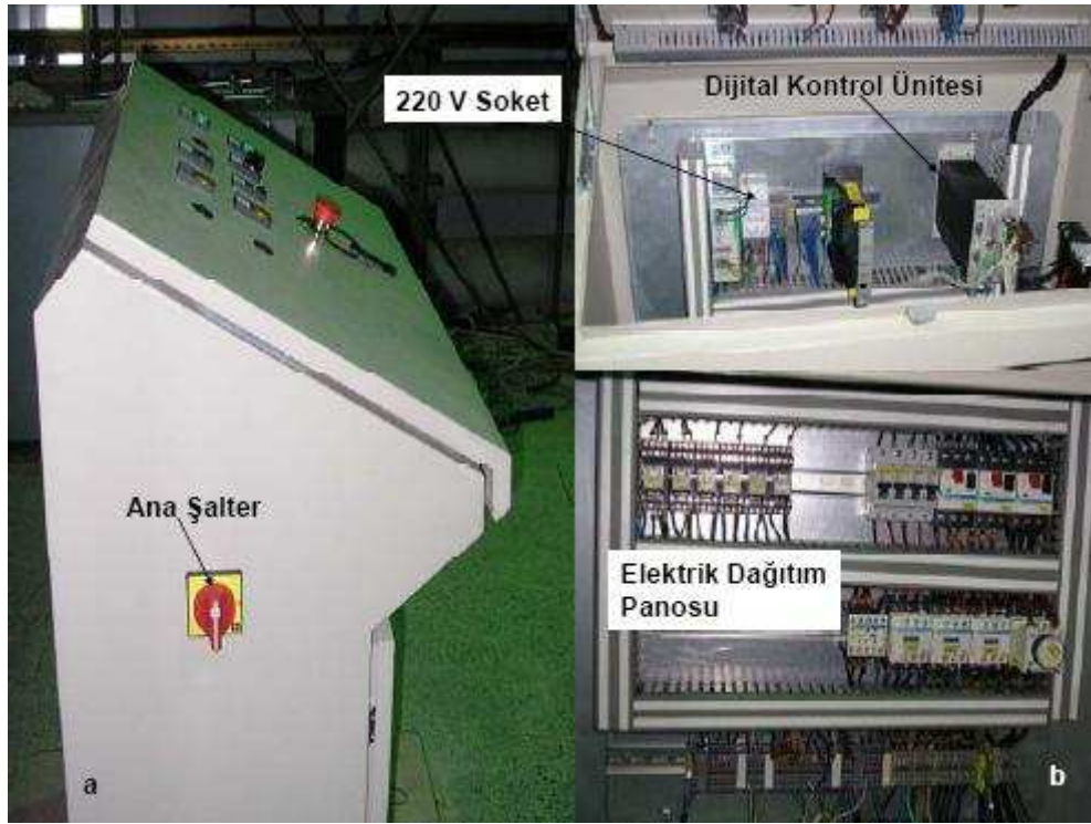
Şekil 3.12 : Kontrol konsolu a) Ana Şalter b) İç görünüm
