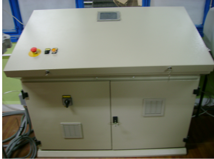
Şekil 8.2 Elektrik Panosu Son Hali (Kapalı)
