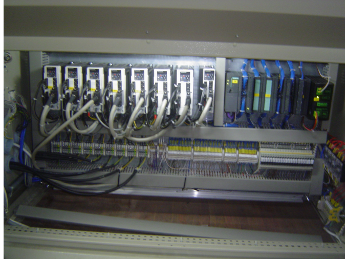
Şekil 8.3 Elektrik Panosu Son Hali (Açık)
