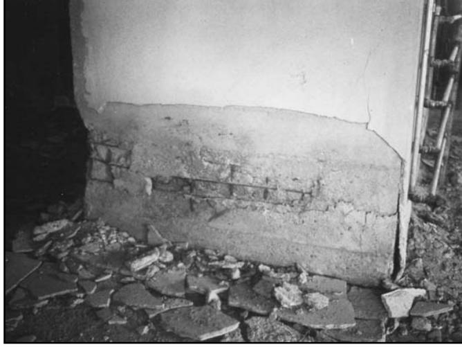
Şekil 3.6 : 3 Şubat 2002 Çay Depreminde yıkılmamış bir bloktaki moment etkisi .
