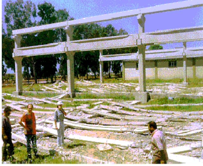
Şekil 8.2 : Adana Organize Sanayi Bölgesinde İnşa Halinde Hasar Gören Prefabrikte Bina
