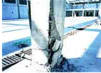
Şekil 8.3 : 1999 Kocaeli Depreminde Sıklıkla Görülen Kolon Hasarı
